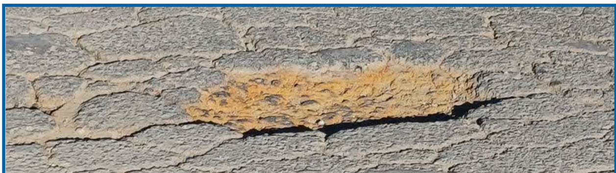
◀◀ شکل ۴) خرابی شدید روسازی آسفالتی از نوع چاله
